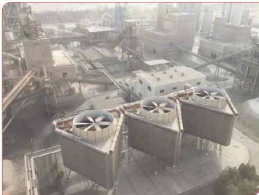
Hình 1: Tổng quan lắp đặt WHR tại SCF.
