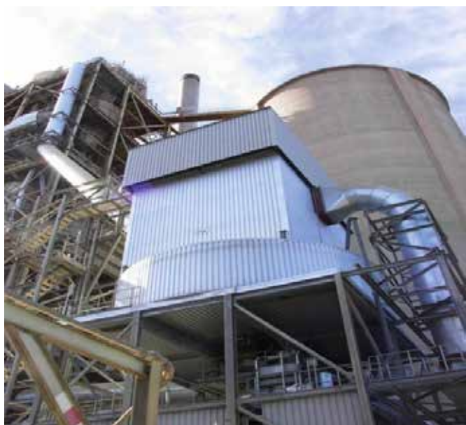
Hình 5: Lọc bụi cooler có đường by-pass
