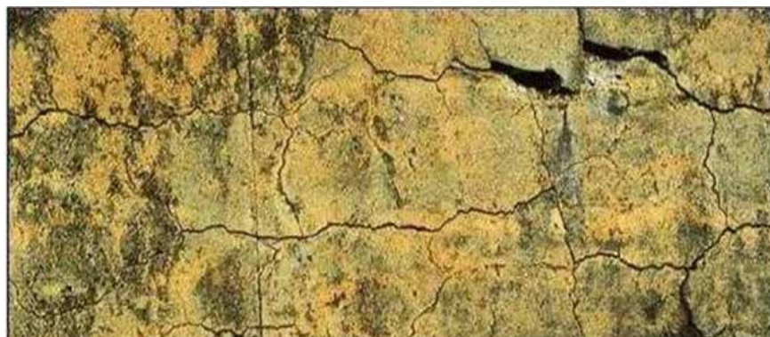
Hình 8 – Nứt bê tông xỉ do phản ứng kiềm cốt liệu
